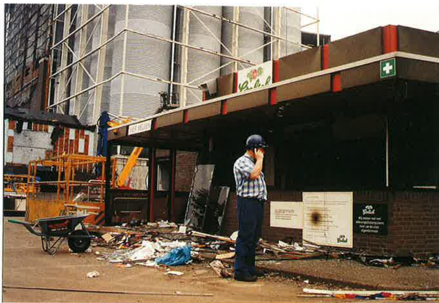
Van de portiersloge aan de Roomweg was nog maar weinig over.
